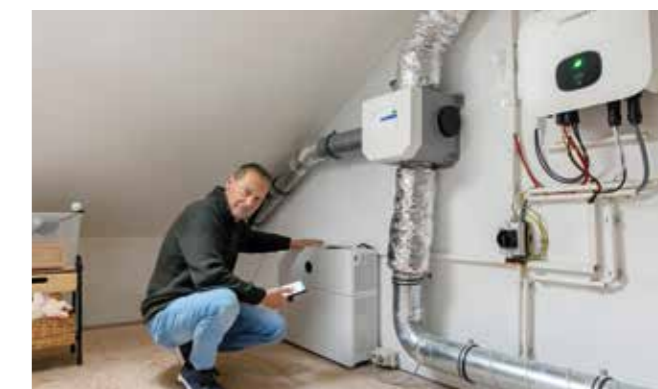
Hans Aalders bij de nieuwe technische installatie op zolder
